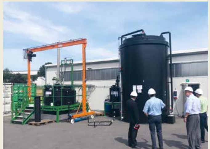
Aussenansicht der Anlage mit Salzsäuretank (rechts) sowie Reaktor, in welchem die MgTh Teile aufgelöst werden (links).
